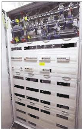
Die Technik steht im Keller.
